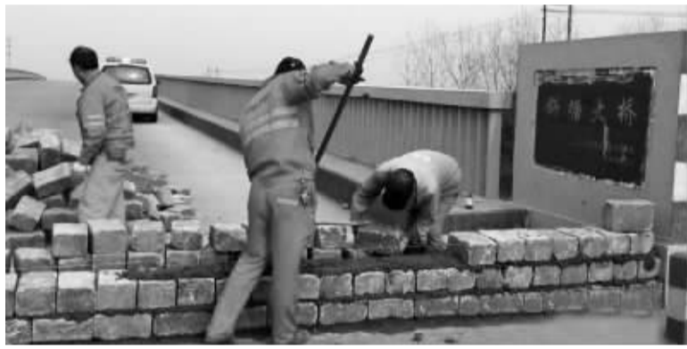
路政养护人员已经对大桥进行紧急封闭。
