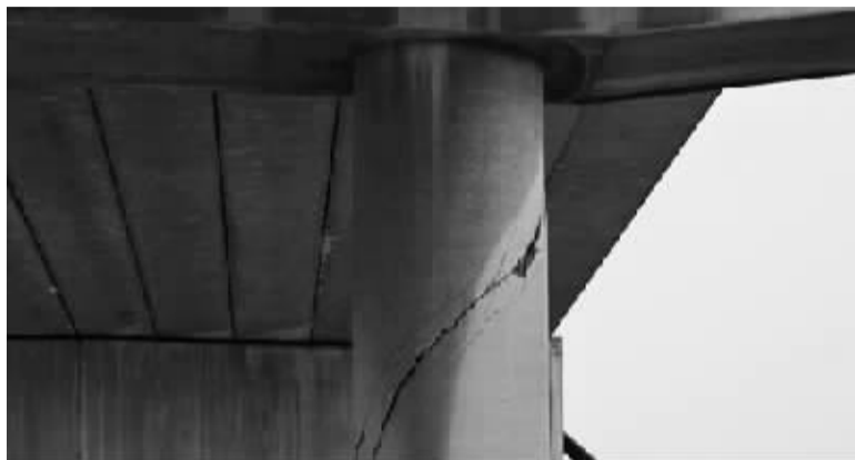
9日晚，松蒸公路斜塘大桥遭到船只撞击，图为桥被撞击后的裂缝。
