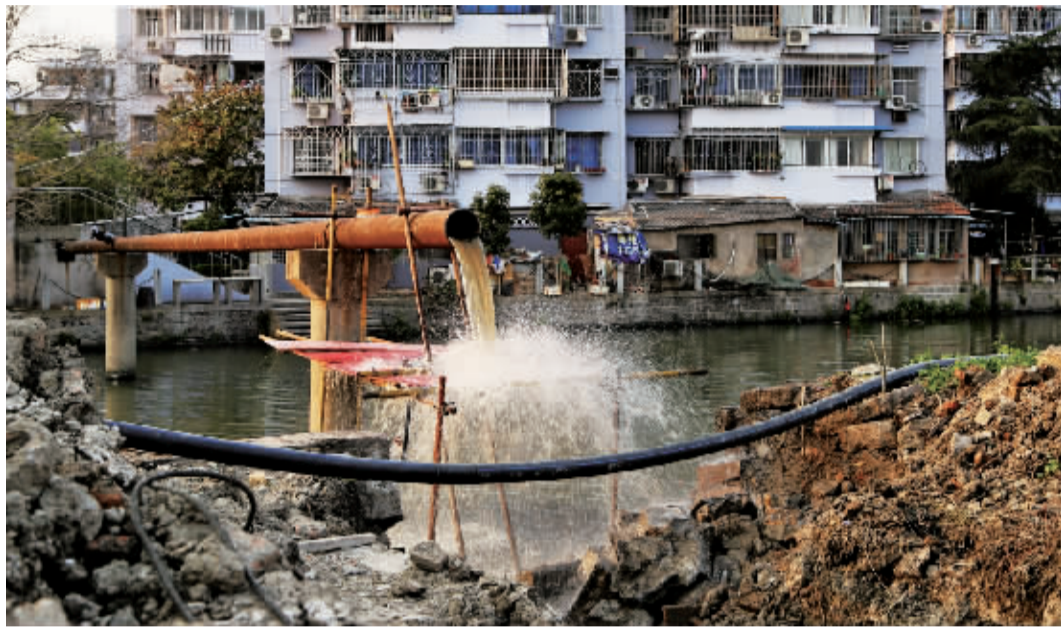
昨天上午，被挖断的管道还在排污水。
