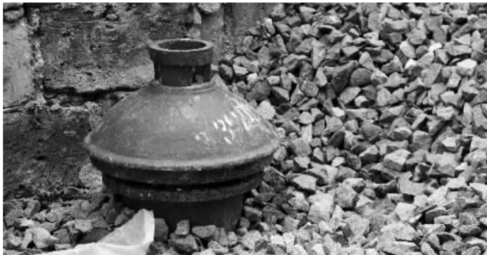
海曙区君子街上被石子掩埋的消防栓。 边城雨 摄
