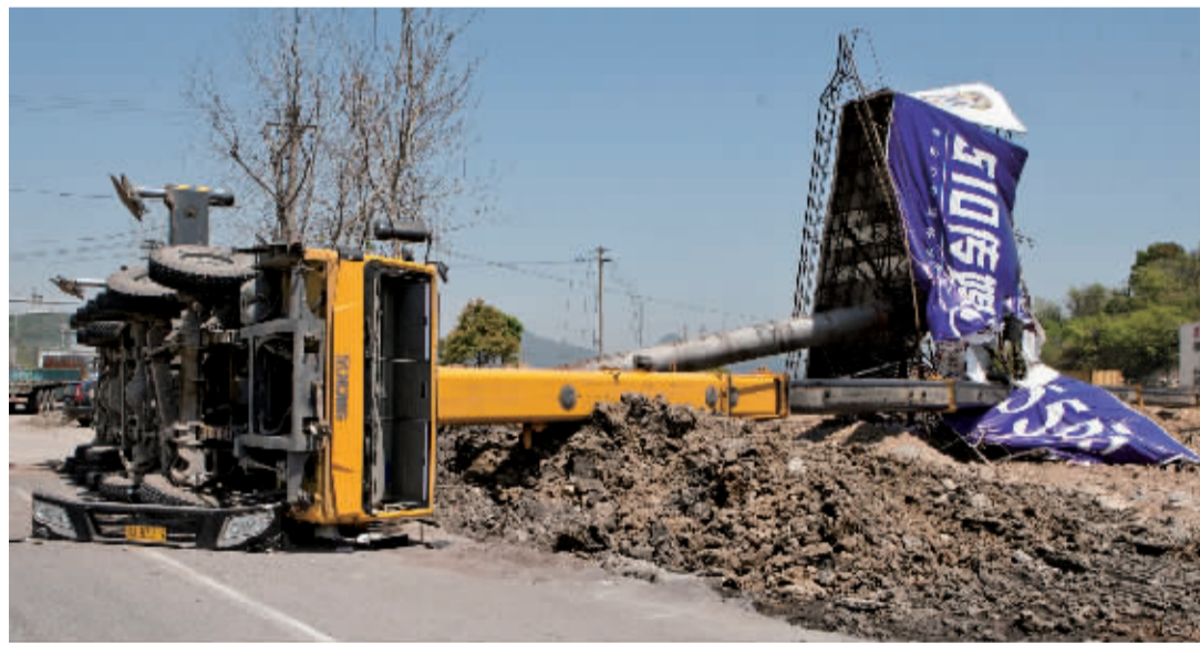
承重200吨的大吊车在拆卸10吨重立柱广告牌时侧翻。 记者 唐严 摄
