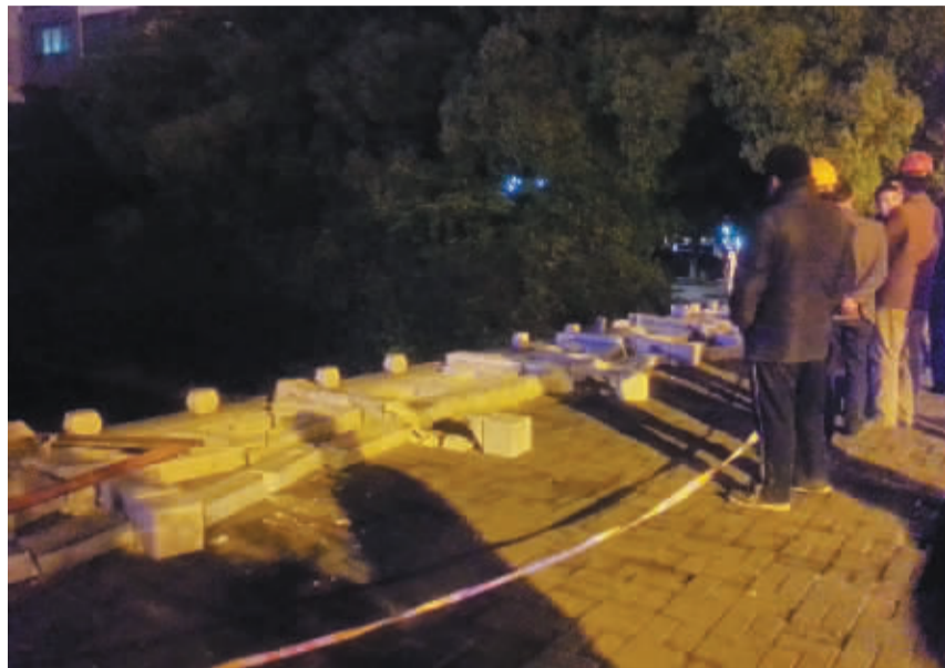
倒在桥上的栏杆。
