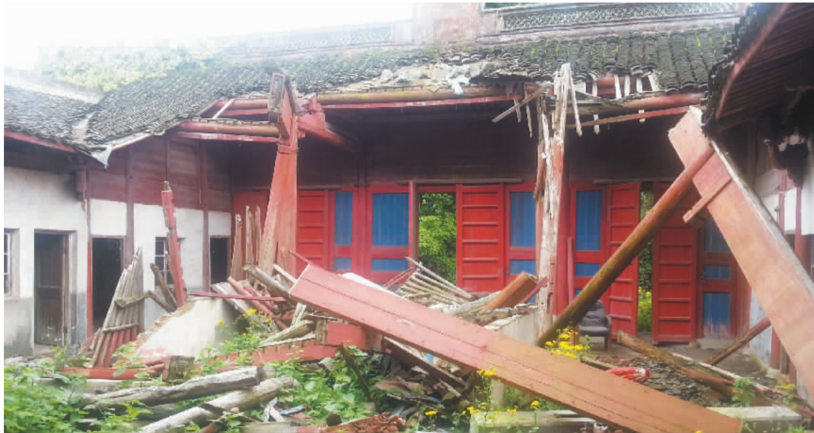
东钱湖灵佑庙杂草丛生、戏台坍塌。
