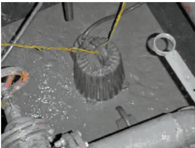
被污泥堵死的排水系统。
