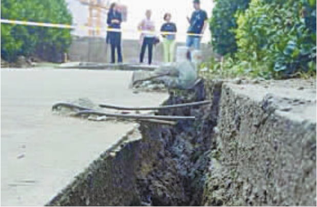
楼房边地面上的裂缝。
