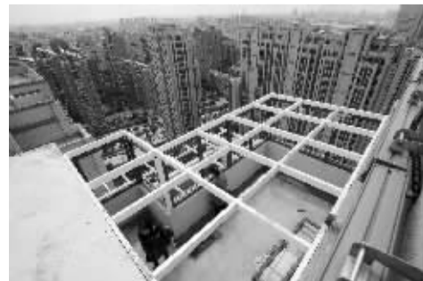
24层楼顶尚未完工的违法搭建。 记者 龚国荣 摄
