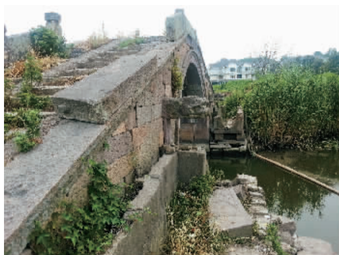
受损的福泉桥 黄金 摄
