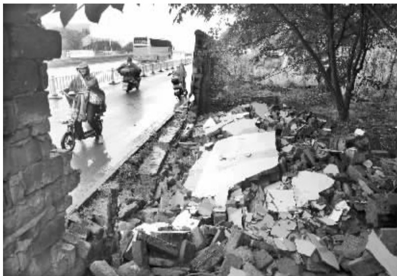
事发现场倒塌的围墙。 记者 龚国荣 摄
