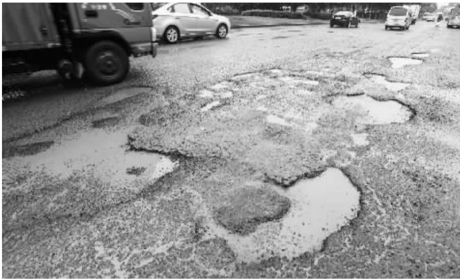
鄞州大道路面坑洼严重。 记者 徐佳伟 摄
