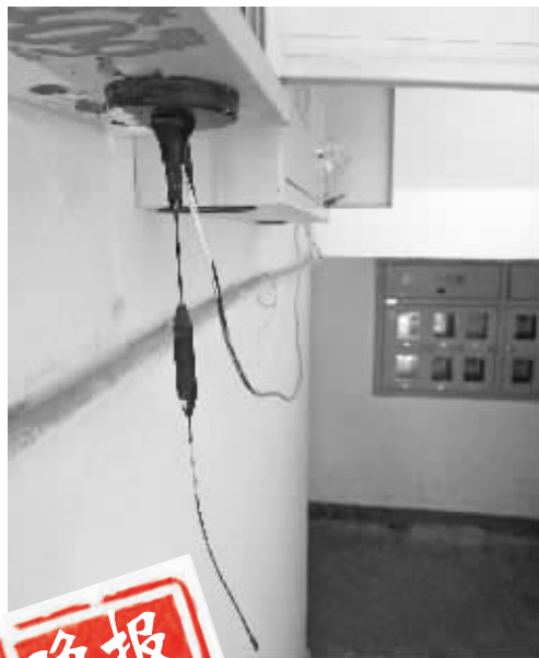
楼道里的无线抄表数据采集器吸盘天线。
