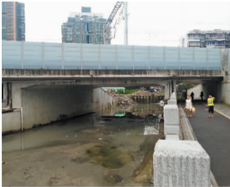
图为积水严重的三市立交桥主桥洞。
