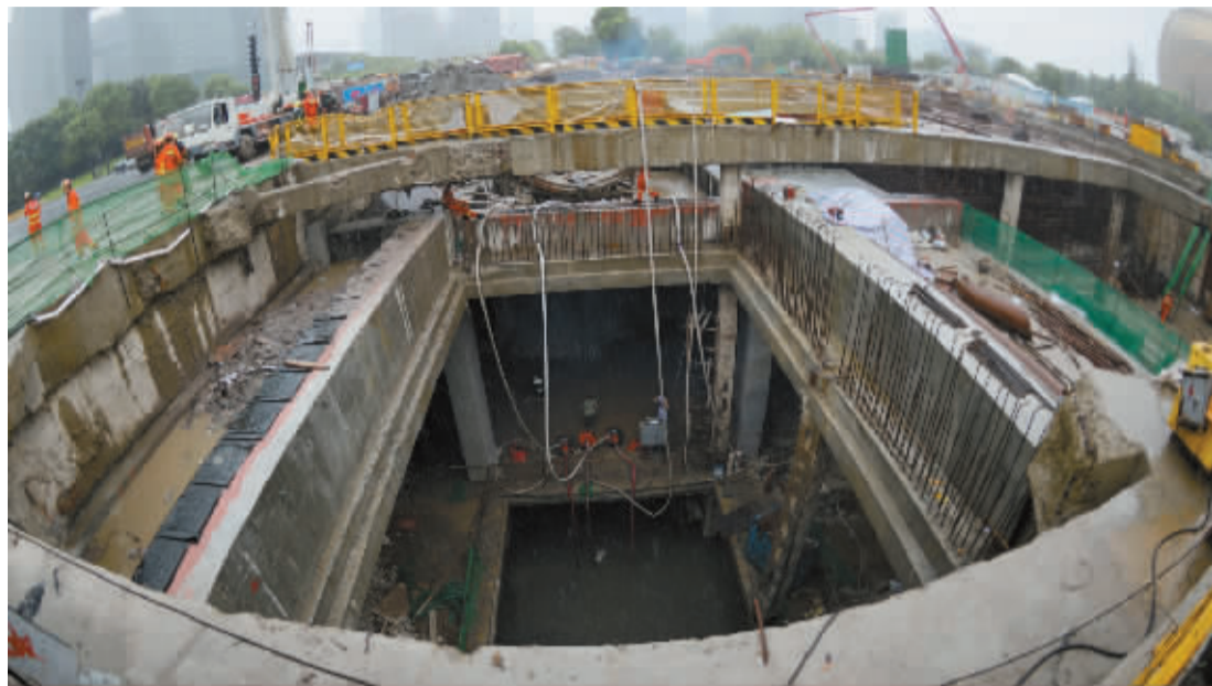
发生透水事故的杭州地铁4号线市民中心站施工现场。 新华社发
