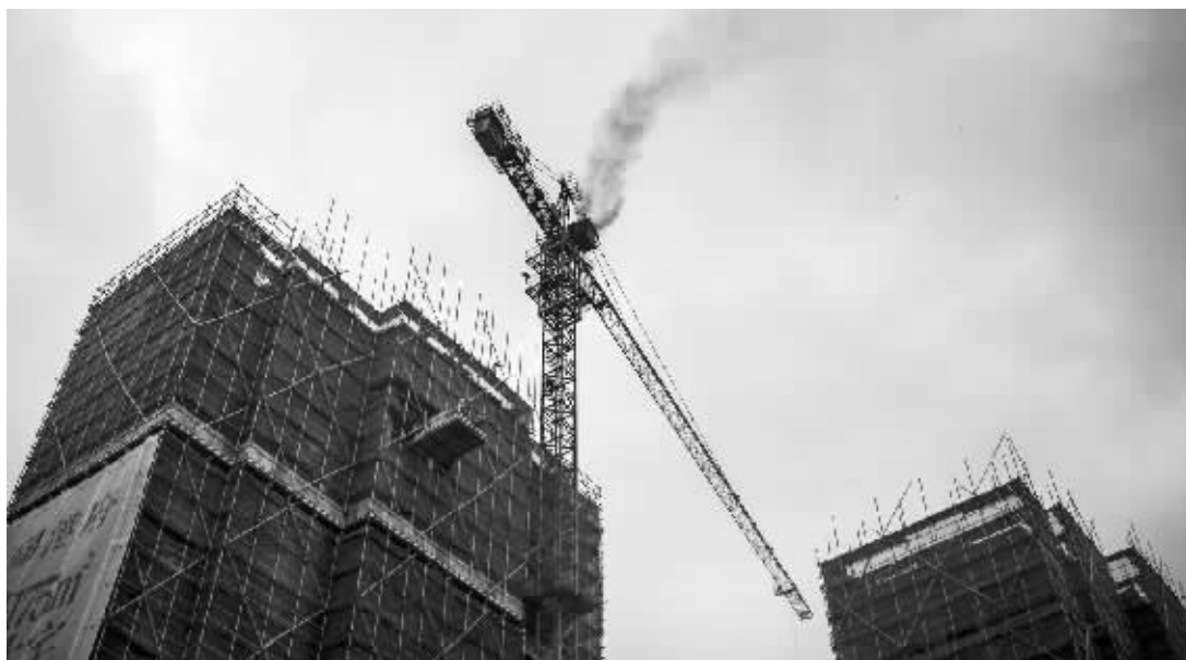
图为正在冒着浓烟的塔吊。
