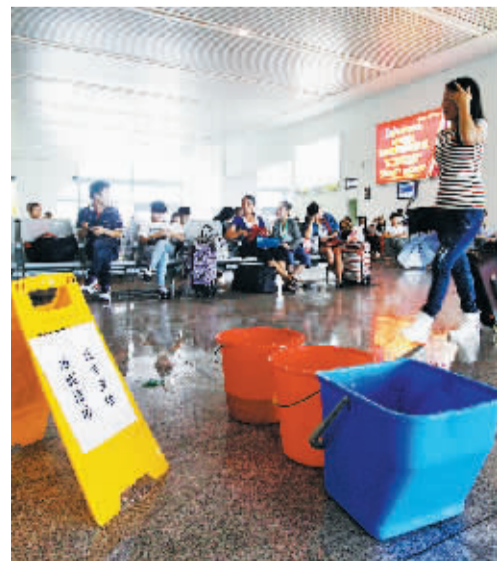
昨天中午,候车大厅地面仍有积水,车站摆放了几个塑料桶来收集平顶上漏下的雨水。
