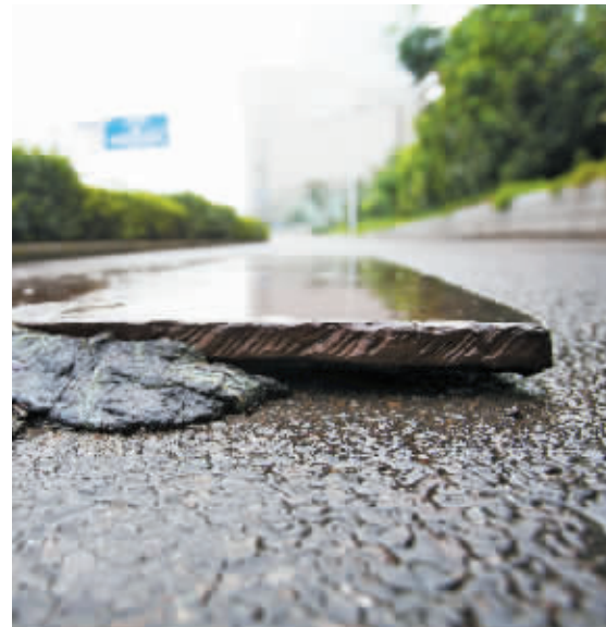
铺在路上的钢板凸出地面不少。
