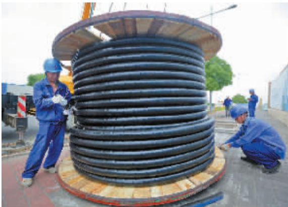
配网“三双”改造中,工作人员正在对电缆盘上的电缆进行解绑。
