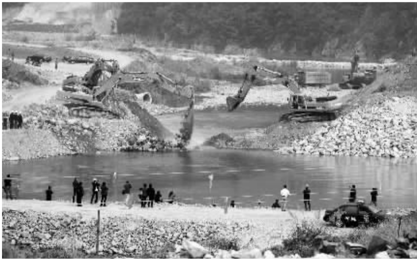
施工机械将砂石料推入水中,围堰龙口逐渐缩小。 记者 许天长 摄
