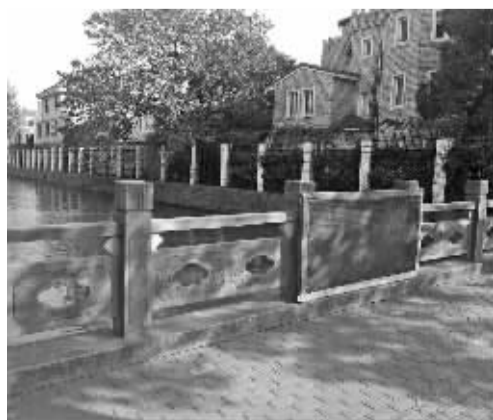
桥栏破损处用铁丝绑着一张棕棚。
