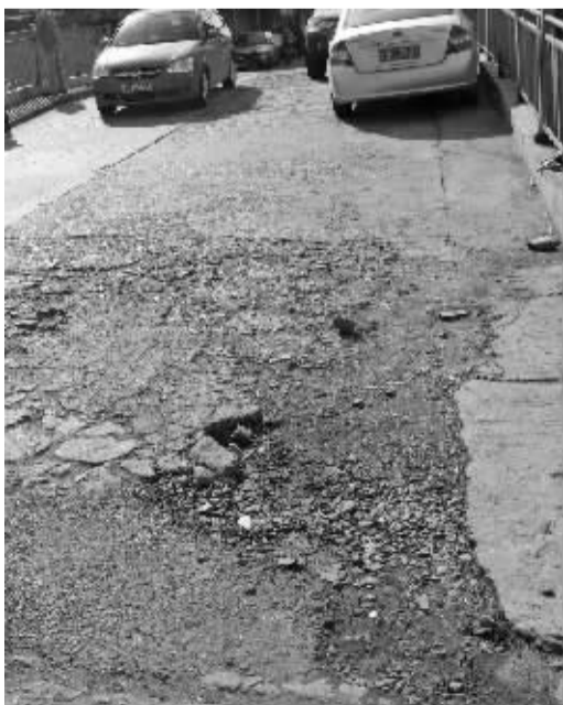
百宁街这段路破损情况很严重。 记者 边城雨 摄
