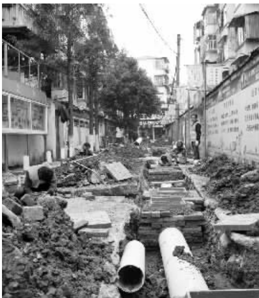
正在施工中的海曙柳汀新村雨污分流改造工程。 记者 边城雨 摄
