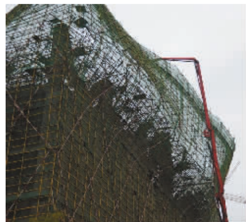
在建工程顶层发生坍塌。
