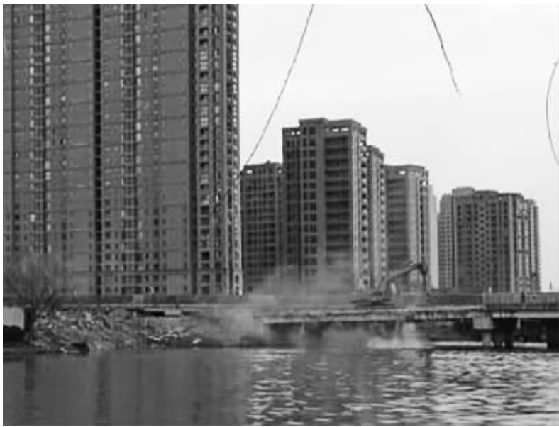
拆桥时,水泥块被弃入河道。 图片由网友拍摄
