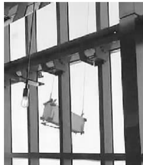
吊箱撞大楼外墙。视频截图
