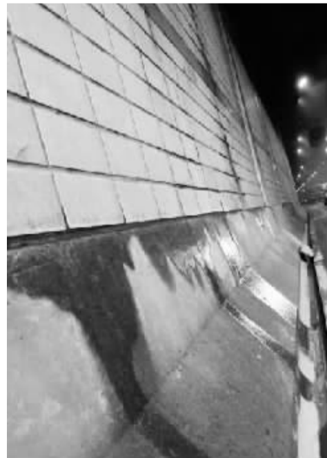
渗水现场。 城管部门供图
