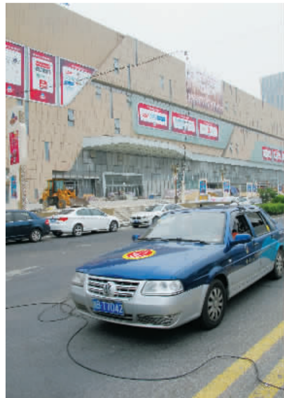
电线拖在马路中间。记者 边城雨 摄
