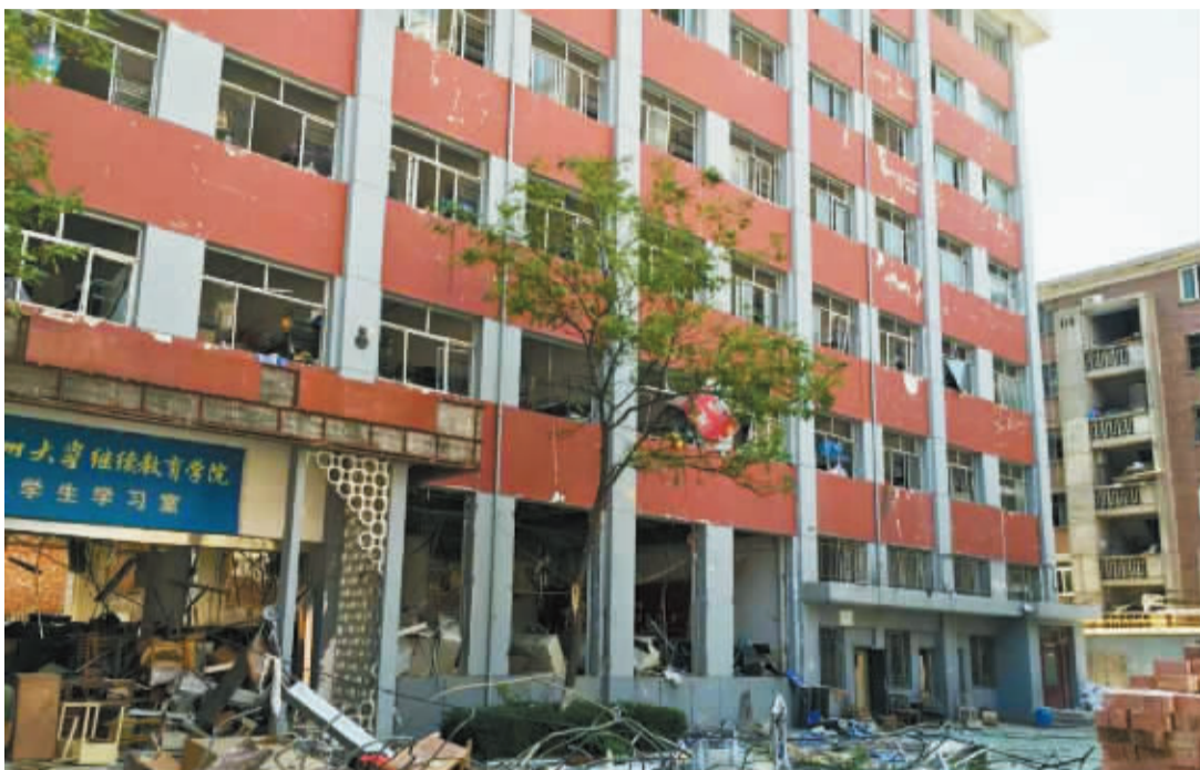
受爆炸冲击的东楼损毁最为严重,七层的玻璃窗均被不同程度震碎,有的窗户已整块脱落。
