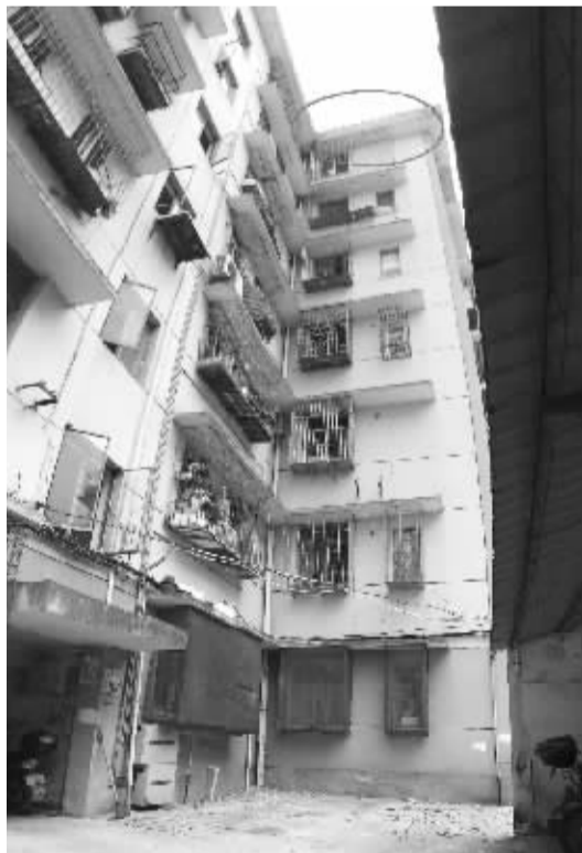
圆圈位置即水泥外墙脱落处。
