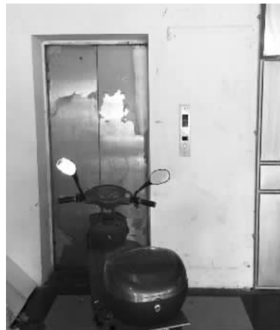
图为华光城一部因没有配件维修而停用的电梯。 记者 边城雨 摄
