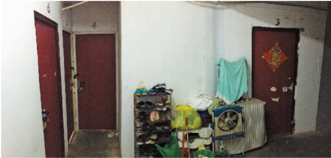
门口走廊堆积了很多杂物。
