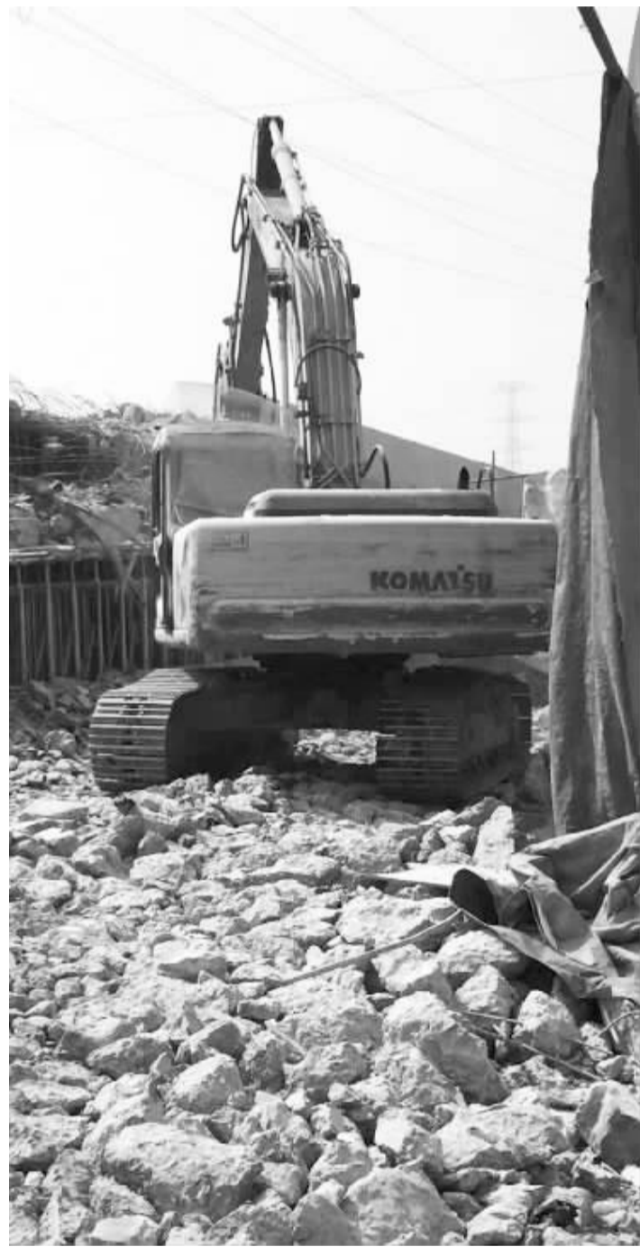
未完工的桥面上到处都是被重新打掉的水泥块。 记者 边城雨 摄
