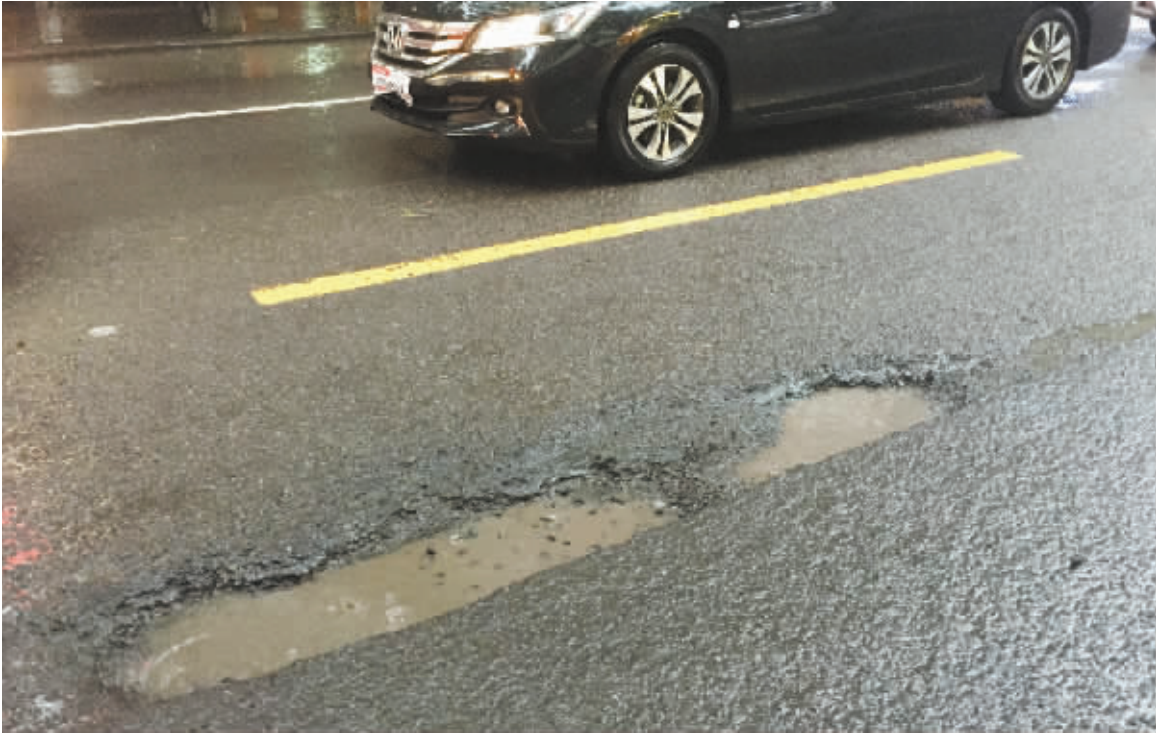
曙光路上的积水坑洼路面。记者 唐严 摄
