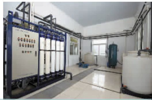
余姚市大岚镇水厂先进的膜处理设备
