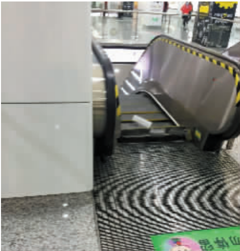
自动扶梯最上方一阶的踏板裂开了。 图片由网友提供
