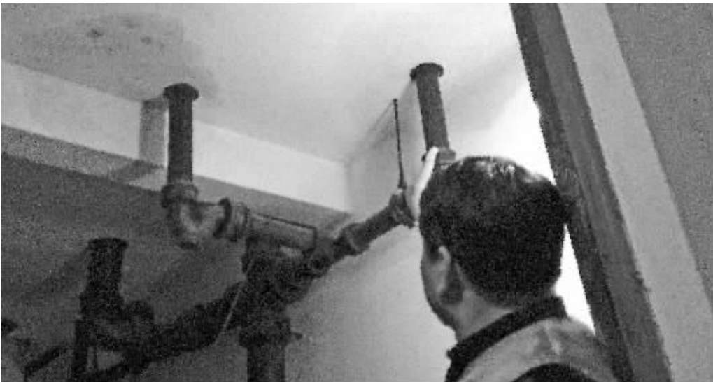
楼下的车棚里已经出现了漏水现象。 记者 殷欣欣 摄
