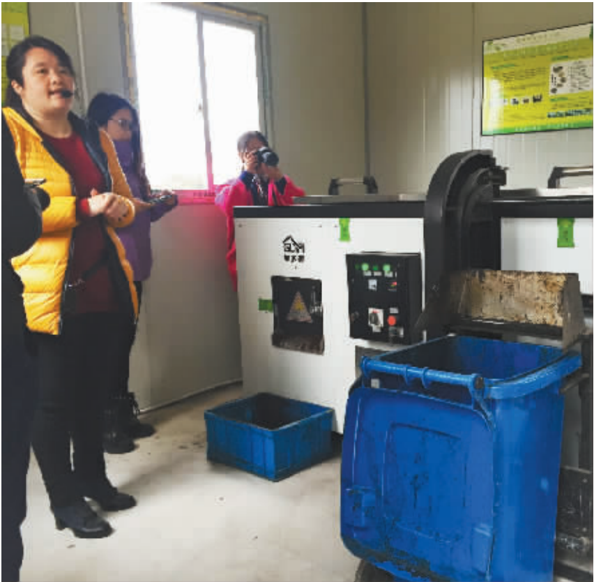
村里的餐厨垃圾处理中心。
