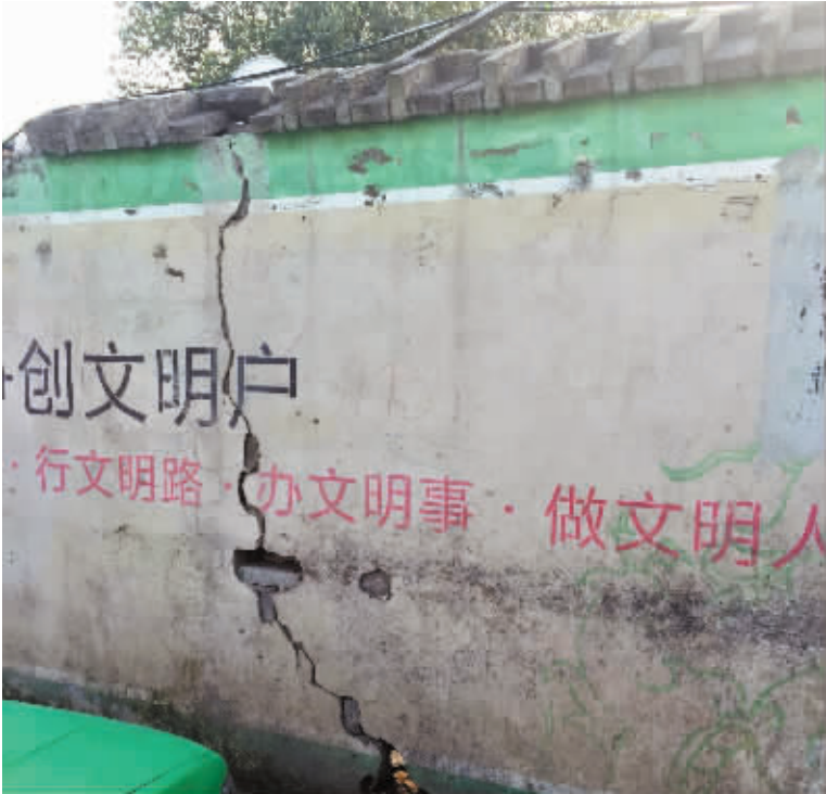
墙体明显开裂。记者 边城雨 摄
