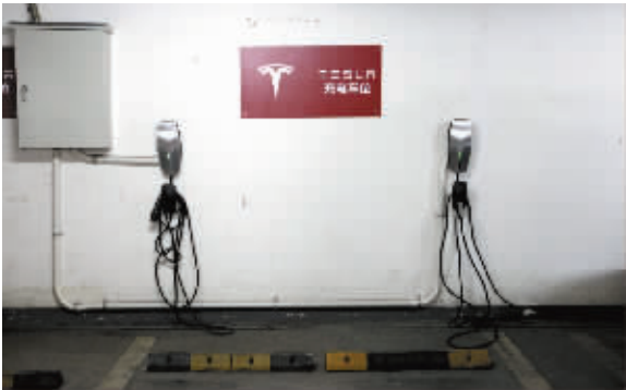
月湖盛园地下车库的电动汽车充电桩。
