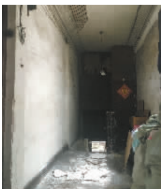
老宅二楼的平顶有不少裂缝,石灰掉落一大块。
