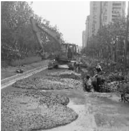
刚修好的清江路路面,又被挖得坑坑洼洼。 记者 张明强 摄
