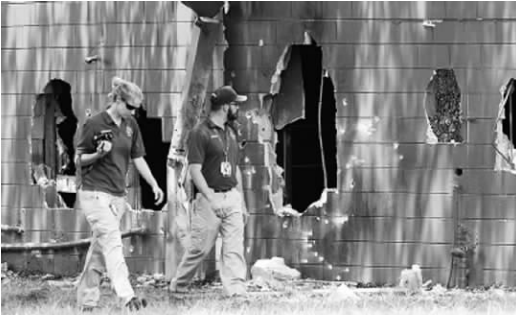
夜店的西侧外墙已千疮百孔。
