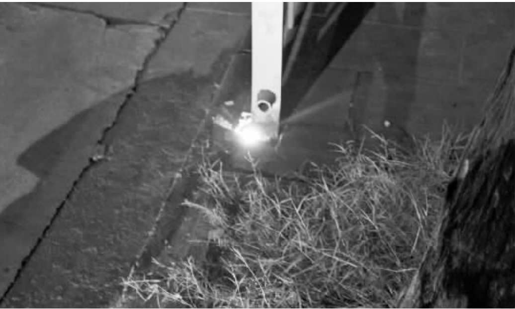
护栏底下不断冒出电火花。通讯员供图
