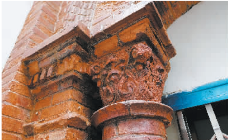
破损的罗马柱
