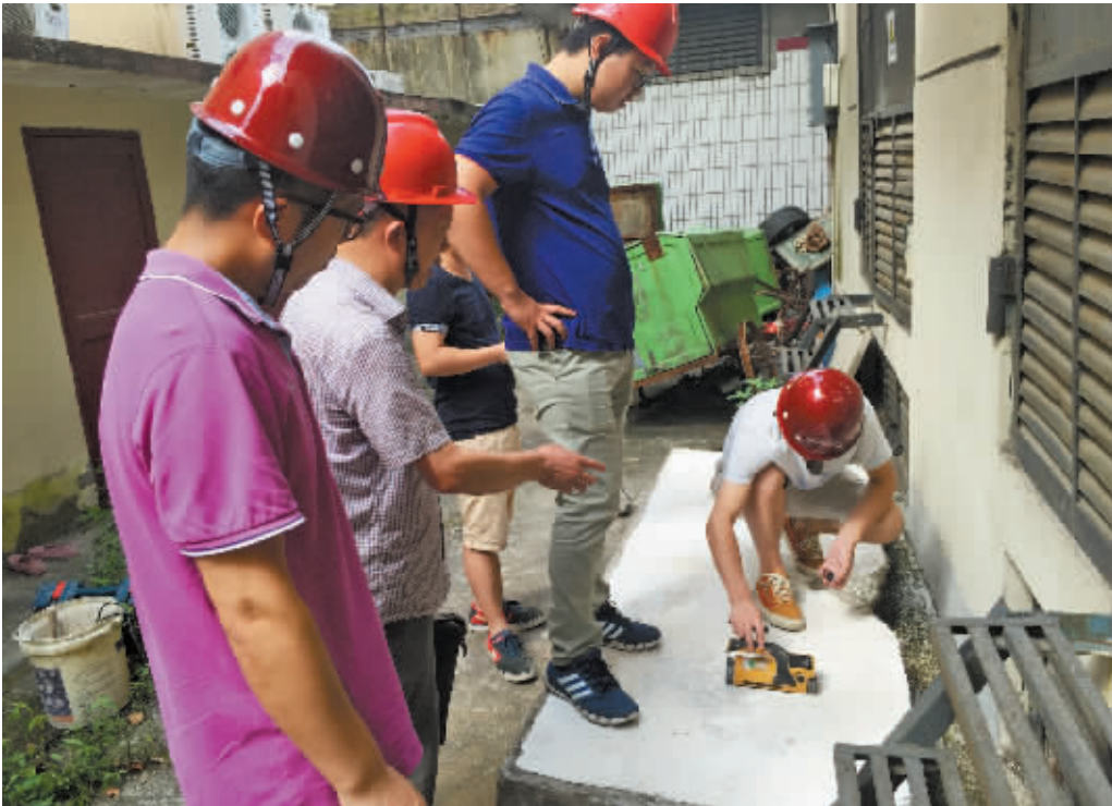
专家和技术人员对塌落的雨檐进行数据采集。
