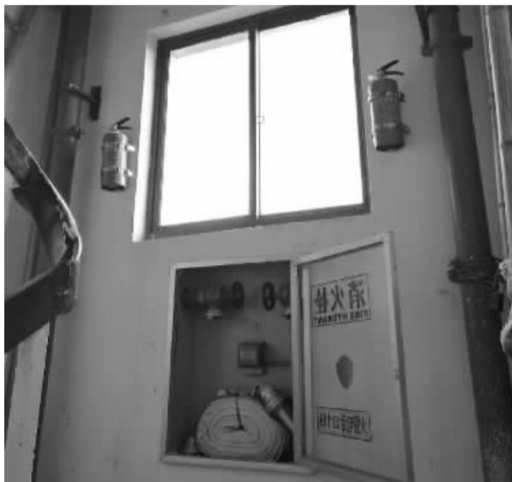
洪塘逸嘉新园小区38幢9楼楼道间的消防栓滴水全无。记者 孔玲 摄
