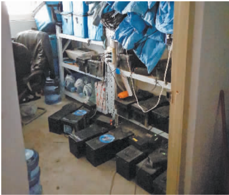
10平方米的储藏室摆满了正在充电的电瓶。
