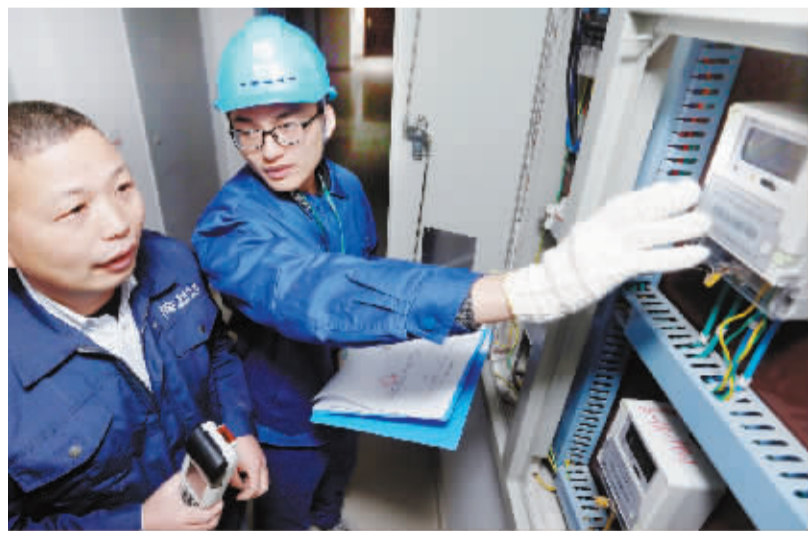
供电和供水的工作人员对新安装的水电表采集器进行检查。通讯员供图
