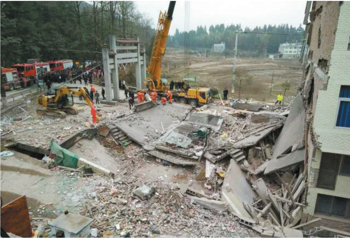
2月2日，救援人员在温州市文成县百丈漈镇外大会村房屋倒塌现场实施救援（手机拍摄）。新华社发
